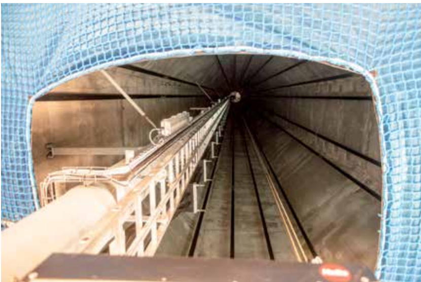
Blick in die Windanlage 01
